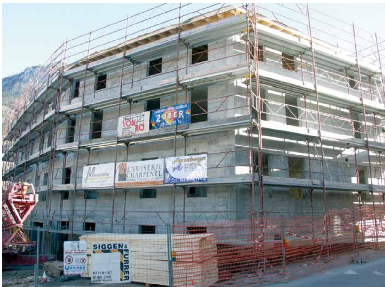
> La pose hivernale est terminée. Le chantier de la Postale a repris par la pose de la toiture.
