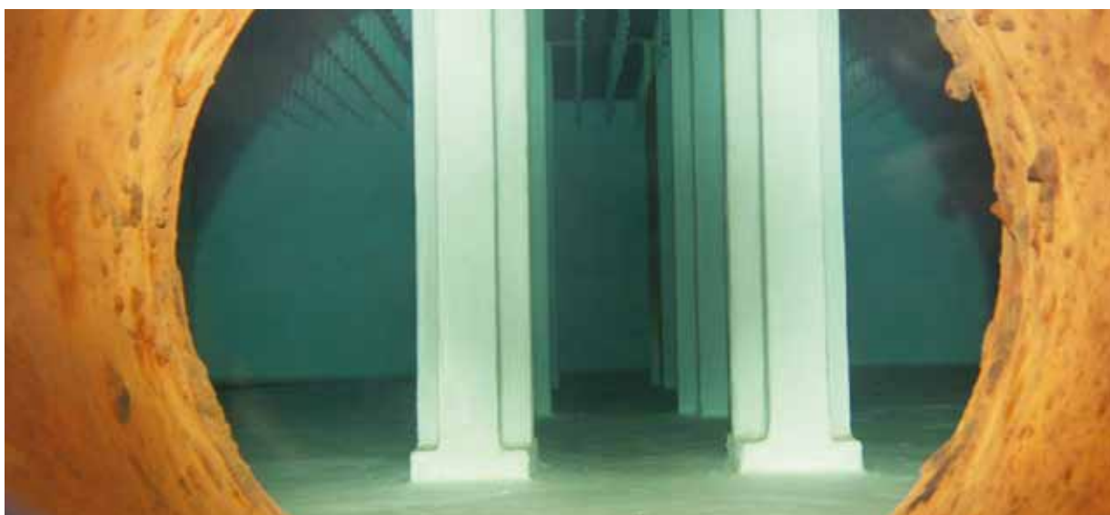
> Une image insolite de la station de traitement des eaux de Sigeroulaz
