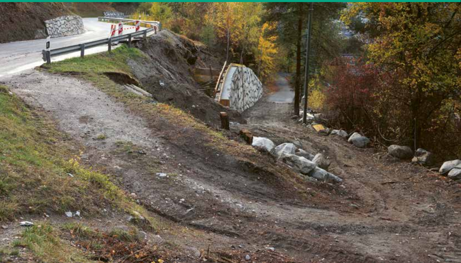
L'Etat du Valais consolide le talus de la route de Vercorin, à Briey
