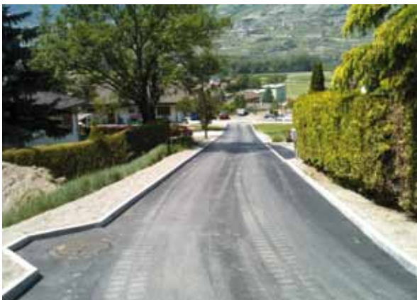
> L'Impasse de la Combache à Réchy, équipée et sous sa nouvelle couverture
