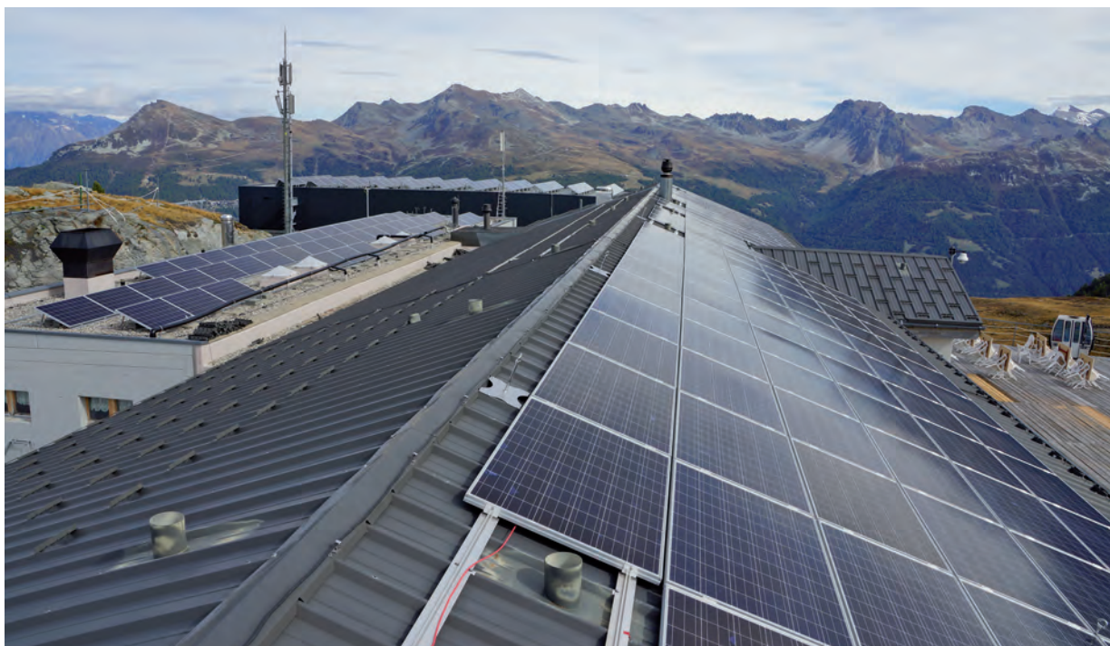
> La première installation solaire d'importance, sur notre commune, a été construite sur les toitures du Crêt-du-Midi par Sierre-Energie et FMV
