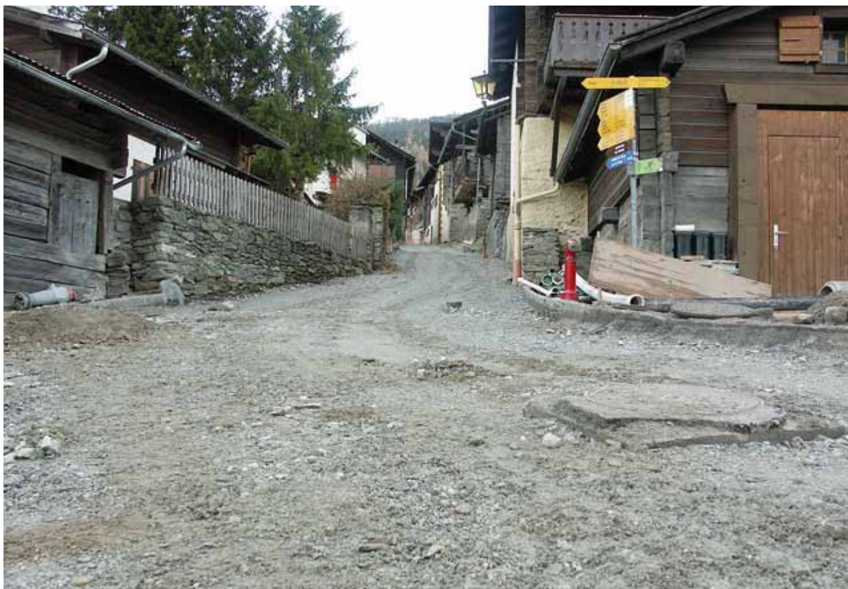
> Les travaux sur le chemin de Tracuit se poursuivront dès le printemps prochain.
